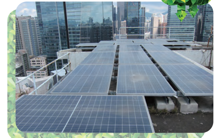
安裝在集團管理物業之一麗港城的太陽能電池板
